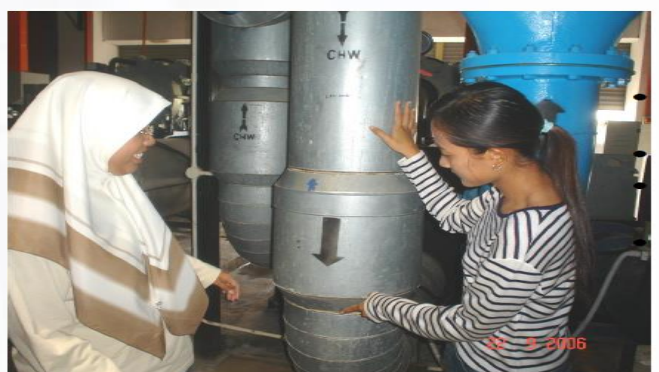
Chiller CHWR and CHWS
