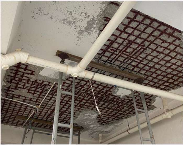
Keadaan soffit slab yang mengalami concrete spalling berskala besar di salah satu tandas Kolej Baiduri sebelum dibaikpulih.
