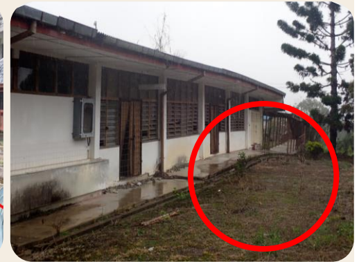
Gambar 10: Salah sebuah bangunan di SMK Kundasang yang rosak teruk akibat kegagalan struktur tanah
